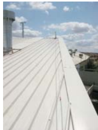
FLEXIBLE DOBLE CABLE SOBRE POSTE EN CUBIERTA.
